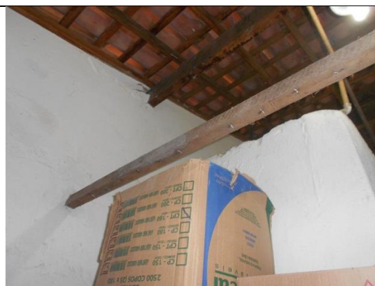
Foto 7: visão do local de armazenamento da merenda na Escola João Faustino de Queiroz, pequeno e sem forro no teto, Chã Grande (PE), 7 de julho de 2015.
