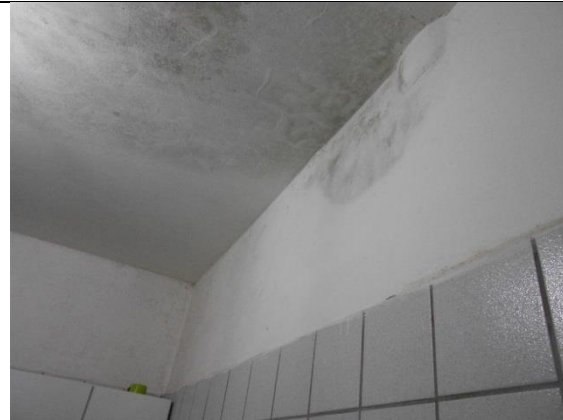
Foto 12: visão da umidade nas paredes e no teto da cozinha da Escola Laerte Pedrosa de Melo, Chã Grande (PE), 8 de julho de 2015.
