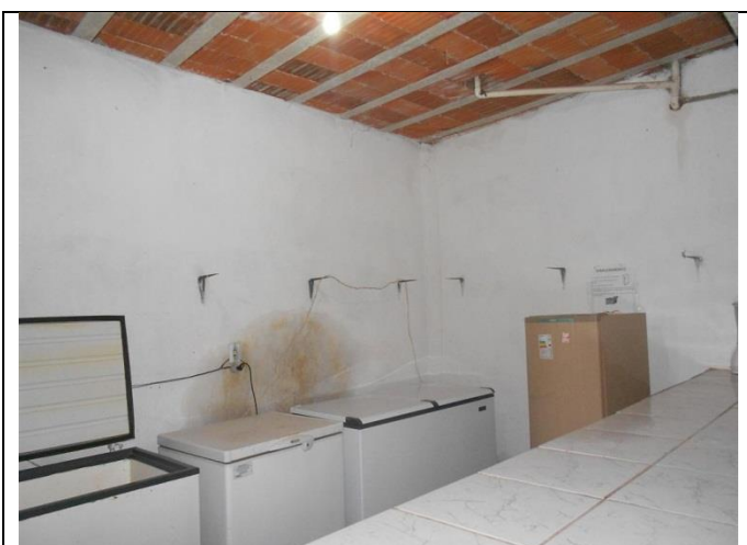
Foto 5: umidade nas paredes do armazém central do Município, Chã Grande (PE), 8 de julho de 2015.
