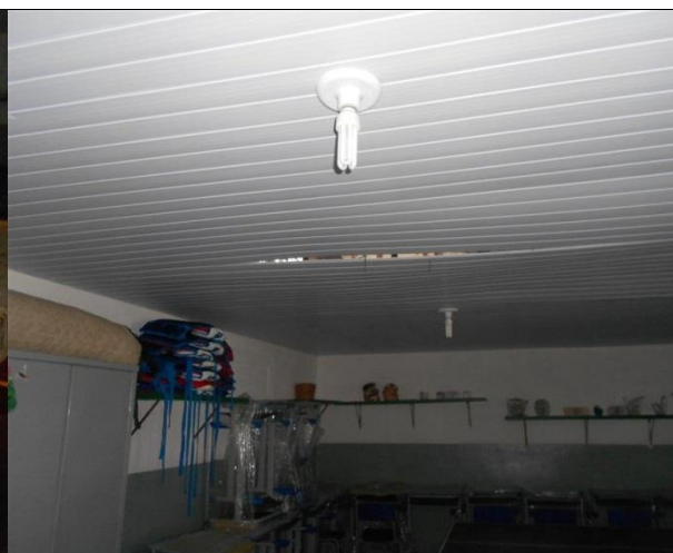
Foto 2: teto com problemas na sala de aula improvisada para consumo da merenda na Escola XV de Março, Chã Grande (PE), 7 de julho de 2015.
