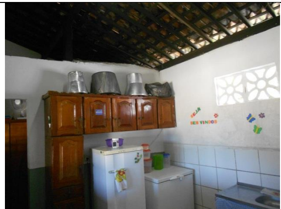
Foto 14: visão da cozinha da Escola José Galdino da Costa, sem forro no teto, Chã Grande (PE), 8 de julho de 2015.
