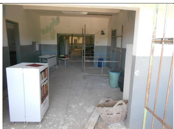
Foto 4: visão do corredor principal da Escola Laerte Pedrosa de Melo, em reforma, na qual não há refeitório para consumo da merenda escolar, Chã Grande (PE), 8 de julho de 2015.
