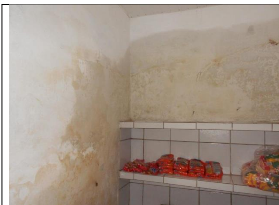
Foto 6: visão da umidade nas paredes do local de armazenamento da merenda na Escola XV de março, Chã Grande (PE), 7 de julho de 2015.
